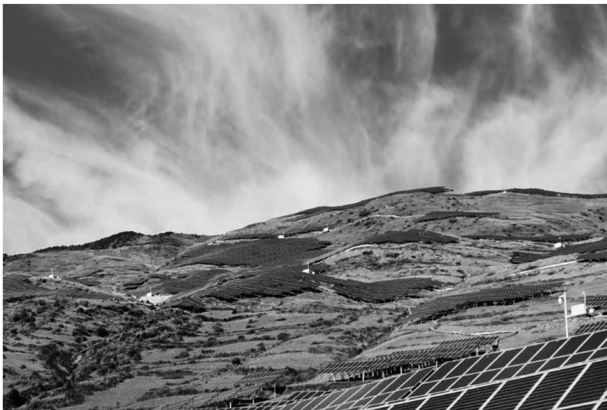
图2-5 位于喜德县的通威牧光一体光伏电站
